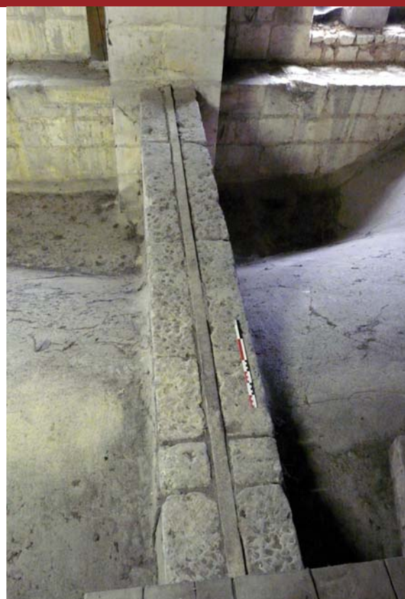
Tirant de fer dans les combles du triforium de la cathédrale Saint-Étienne de Bourges. Cet ensemble de tirants, d'environ 4,5 m de long pour une quarantaine de kilogrammes, relie à chaque travée les culées des arcs-boutants au mur du triforium. Ils sont probablement contemporains de la construction de la cathédrale dans le courant du XIIIe siècle. Toutefois, des marques de réfection au niveau des culées et l'absence de tirants à certaines travées peuvent faire s'interroger sur leur origine. L'analyse métallographique de ces pièces permettra de conforter l'une des deux hypothèses.
